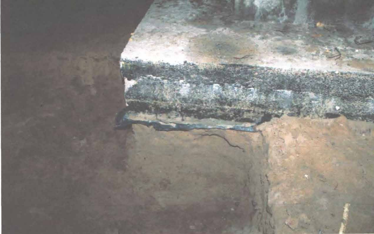
Шурф №2: отдельно стоящий монолитный фундамент в осях 4-Е
